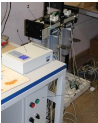
1 – блок управления, 2 – вакуумный выключатель, 3 –стенд для подачи питания и команд включения и отключения
