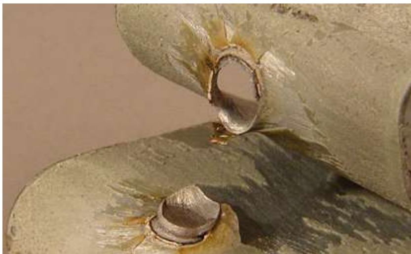
Рис. 1.10. Разрушение соединения по основному металлу
